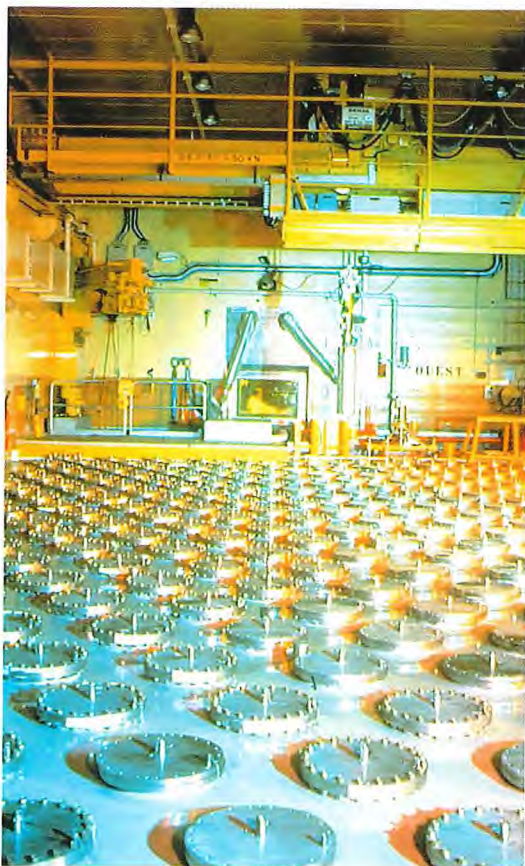
Installation d'entreposage CASCAD
