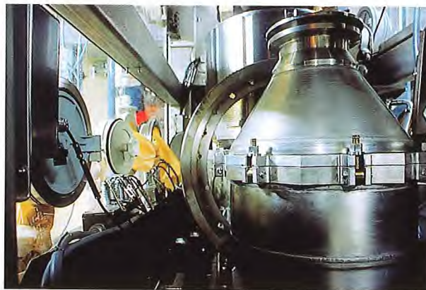
MELOX : jarre à boulets au poste de broyage
