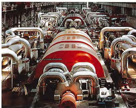
Centrale de Dampierre – salle des machines
