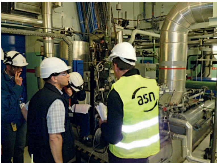
Exercice de démarrage de la turbo pompe de secours ASG lors d'une inspection de l'ASN à la centrale de Flamanville – Juin 2013
