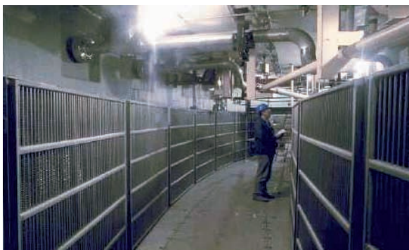
Filtres des puisards de recirculation
