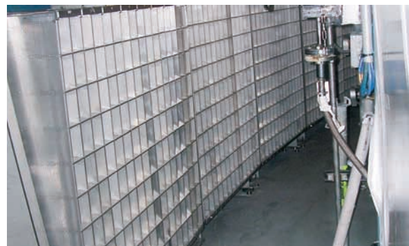
Gros plan des filtres des puisards de recirculation
