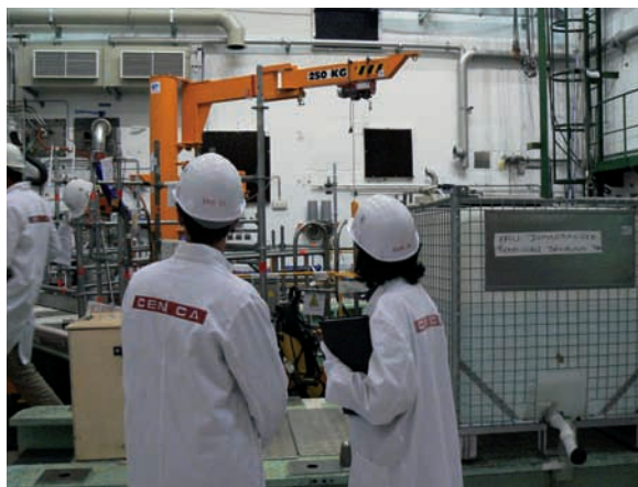
Inspection de l'ASN sur le réacteur CABRI à Cadarache
