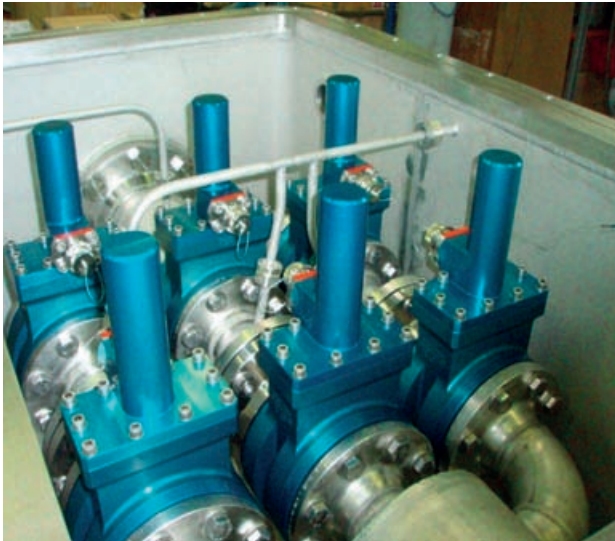
Vannes du circuit de renoyage ultime dans le caisson du RHF
