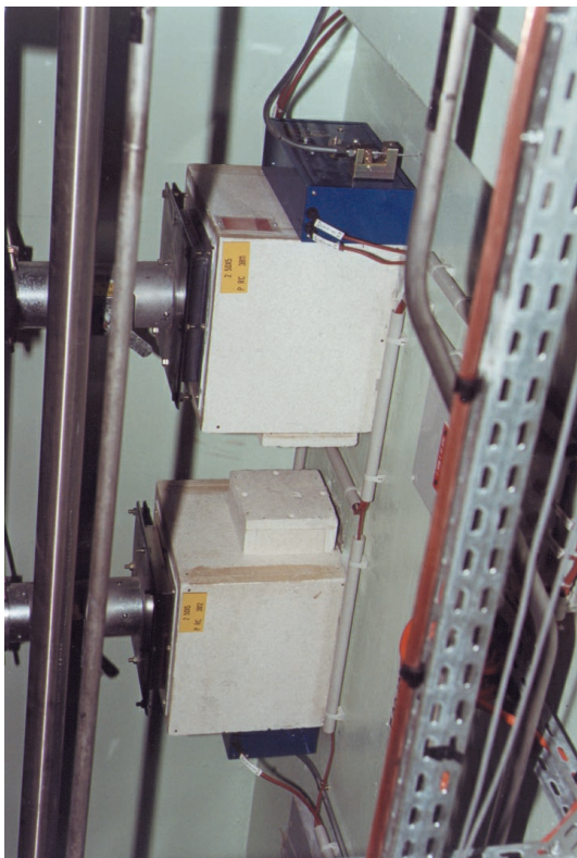
Maintenir en état 3500 clapets coupe-feu dont 3200 asservis...
