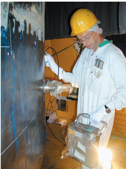
Contrôle par ultrasons de la soudure finale d'un générateur de vapeur remplacé
