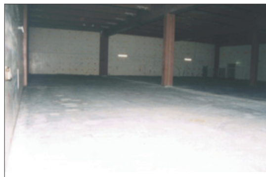
Le démantèlement et l'assainissement de la zone frittage de l'installation FBFC Pierrelatte : avant / après
