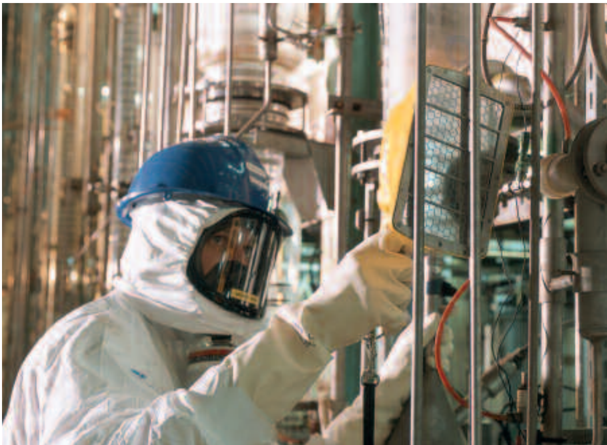
Contrôle radiologique de l'extérieur des colonnes pulsées, après assainissement et avant démontage dans le bâtiment 91 de l'INB 57. Chantier de démantèlement assuré par la société SOGEDEC, site de Fontenay-aux-Roses
