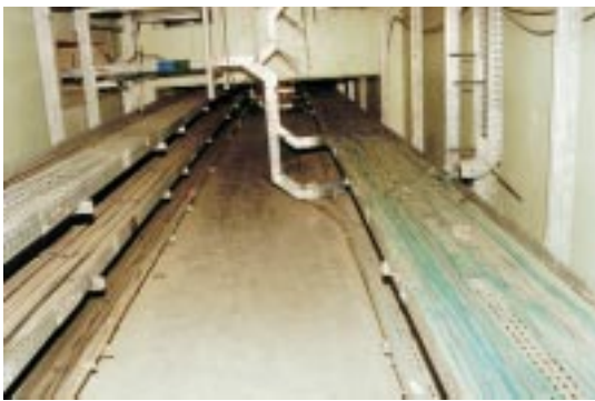
Sur le site de La Hague – Dans l'atelier R4, les chemins de câbles sont regroupés dans des galeries dédiées séparées des couloirs de circulation
