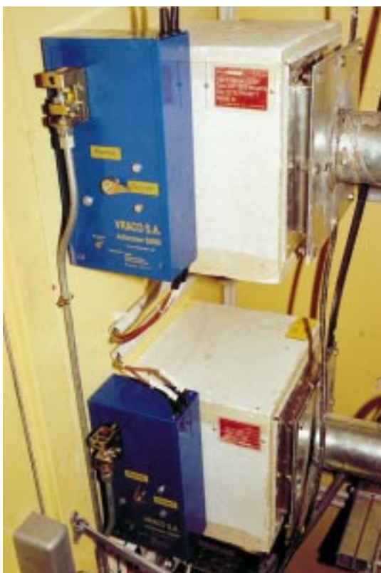
Sur le site de La Hague – Ces clapets coupe-feu, installés notamment sur les conduits de ventilation des cellules classées « secteur de feu » de l'atelier R4, se ferment en cas de détection d'incendie dans la cellule
