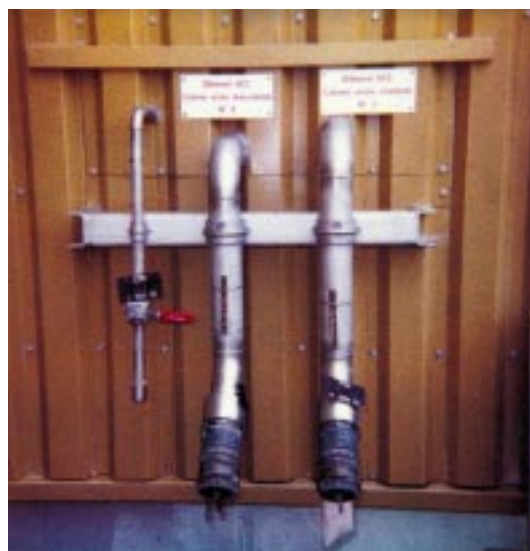
Sur le site de La Hague – Sur chaque face du bâtiment, deux raccords pompiers alimentent des « colonnes sèches » de l'atelier de compactage des coques AU
