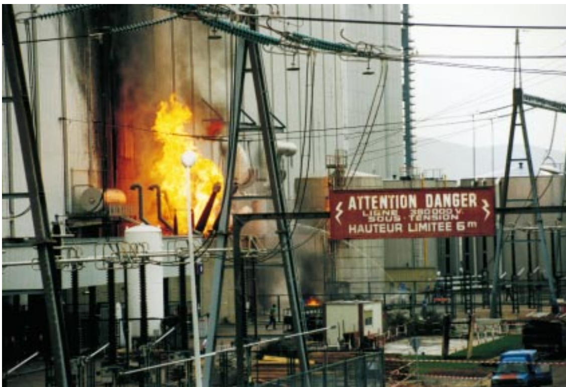
Incendie d'un transformateur T4 sur le CNPE du Bugey
