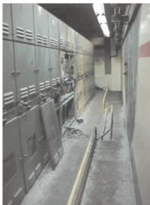
Vue d'un tableau électrique affecté par un incendie (centrale du Bugey, 31 juillet 1999).
