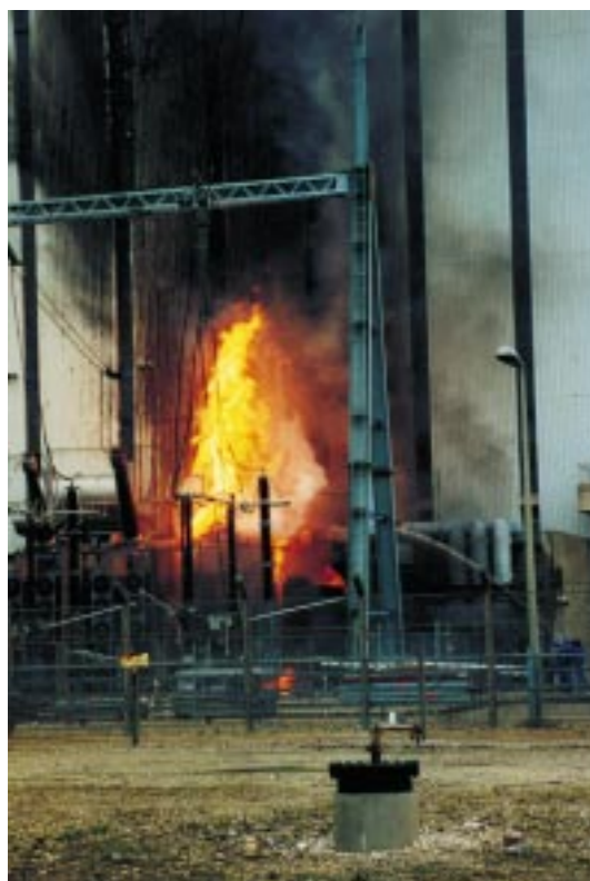
Incendie d'un transformateur T4 sur le CNPE du Bugey
