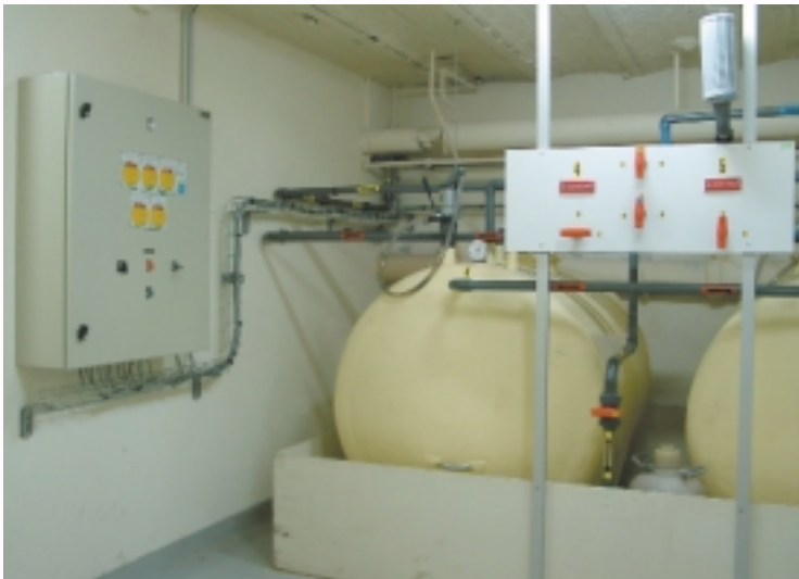
Système de cuves pour recueil d'effluents radioactifs après scintigraphie
