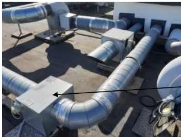
Extracteur N°15 du bras d'aspiration en salle d'injection N°1
