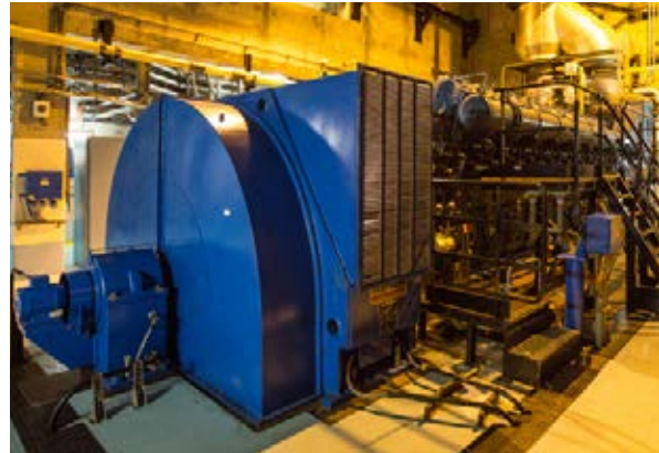
Groupe électrogène de secours à moteur Diesel de la centrale nucléaire de Penly
