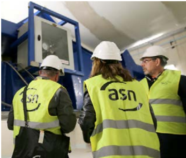
Inspection de revue de l'ASN à la centrale nucléaire de Gravelines – mai 2018
