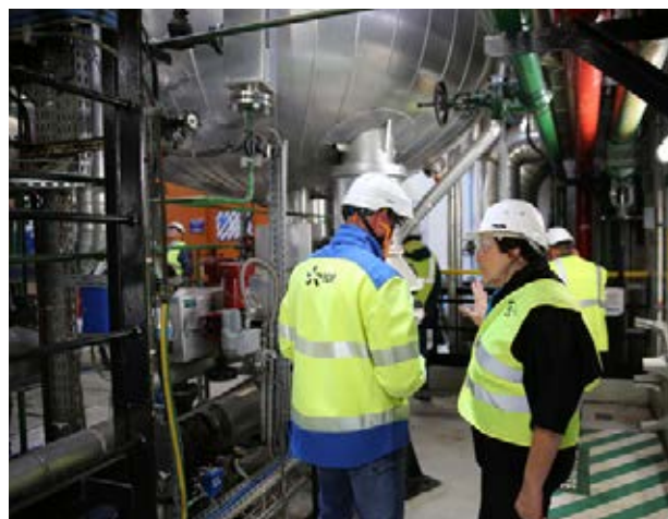
Inspection de revue de l'ASN à la centrale nucléaire de Gravelines - mai 2018
