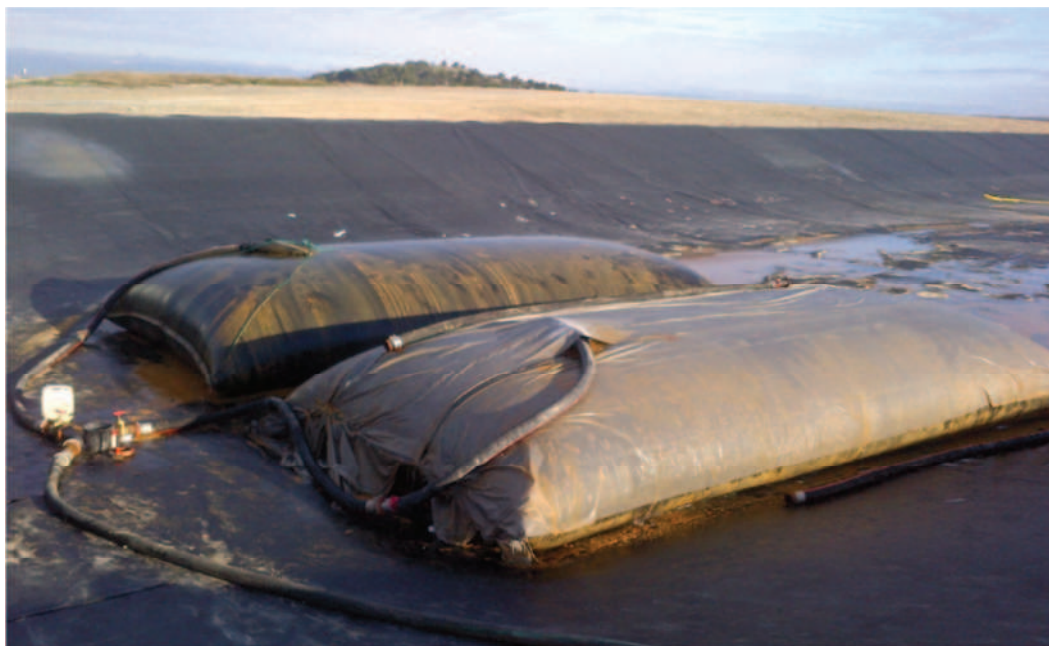
Figure 38 : Vue réalisée lors des essais industriels de filtration en géotubes pour déshydrater les boues
