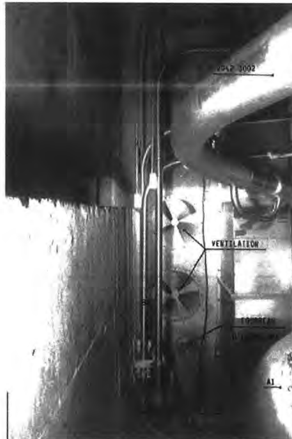
Figure 9 – Photographie des fourreaux FE 05 et FE 06 et environnement évaporateur 2042-30
