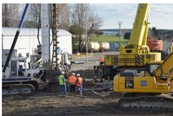
Travaux de construction des diesels d'ultime secours dans le cadre des modifications liées au « post-Fukushima ».
