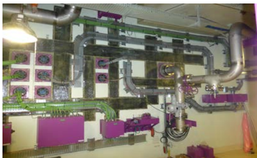
Nouveau circuit de refroidissement par l'eau de nappe
