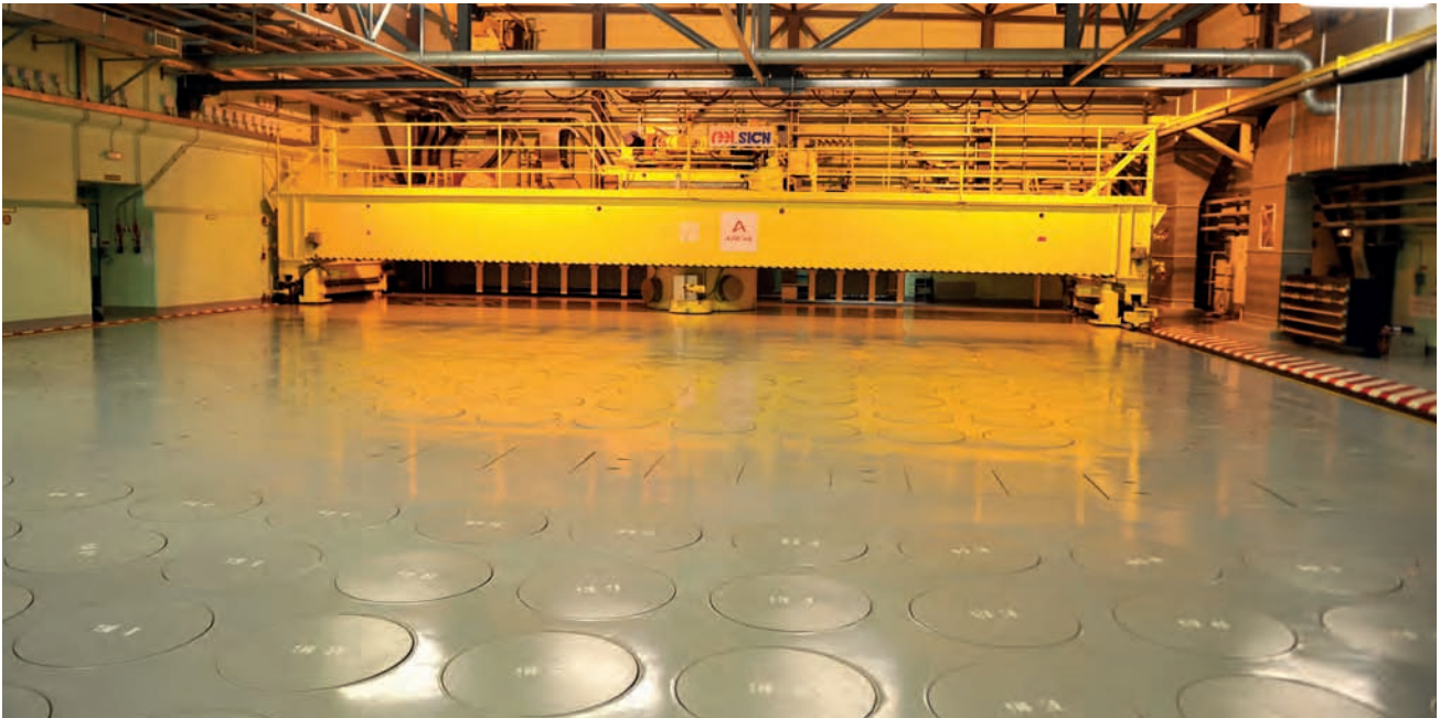
Atelier de vitrification 17, usine de traitement des combustibles usés, La Hague.
