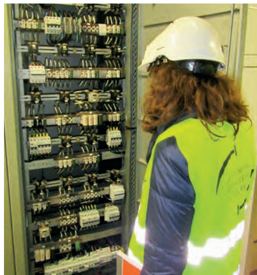
Inspection de l'ASN du système électrique de l'AMI, à Chinon, 2016.
